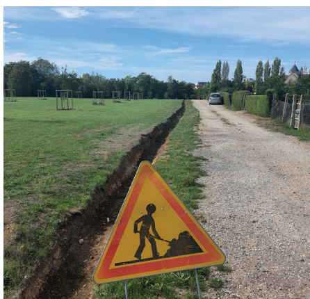
Aménagement de la vallée du coin de Terre, le long des jardins familiaux.
